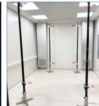
Sonde termiche di verifica
